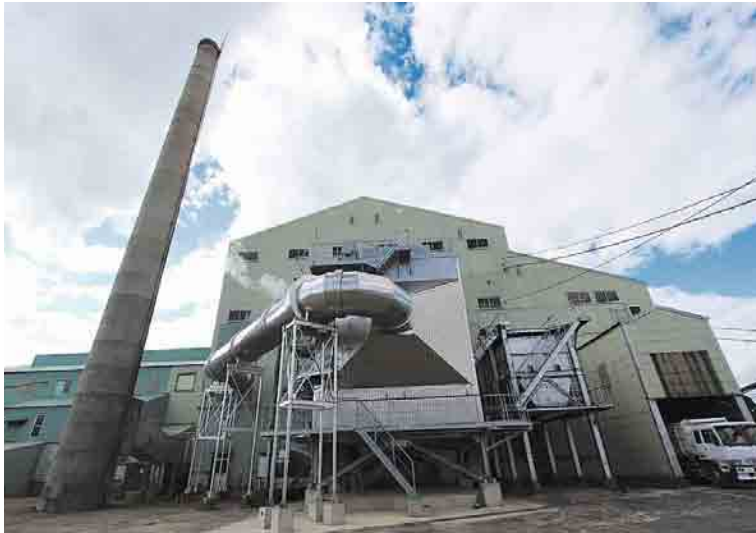
ボイラーから排出するばい煙を除去する電気集塵機
