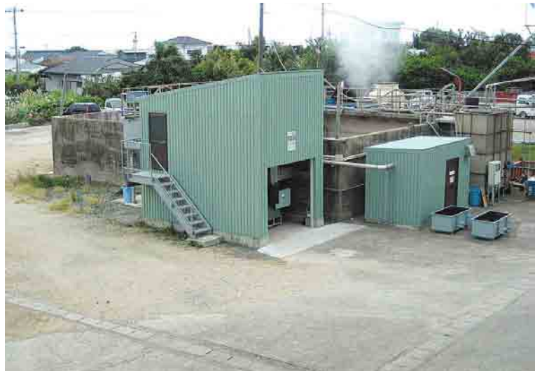
製糖工程から出る洗浄水をクリーンにする排水処理設備
