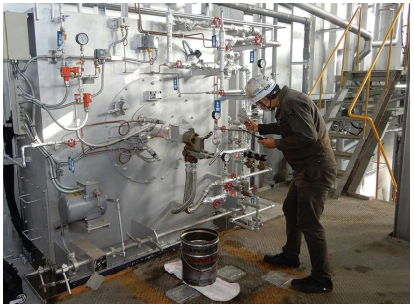
ボイラー(バーナー部分)
